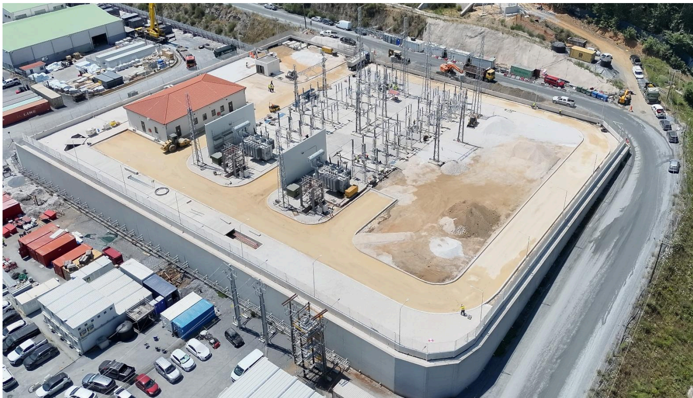
Υποσταθμός της μονάδας επεξεργασίας
